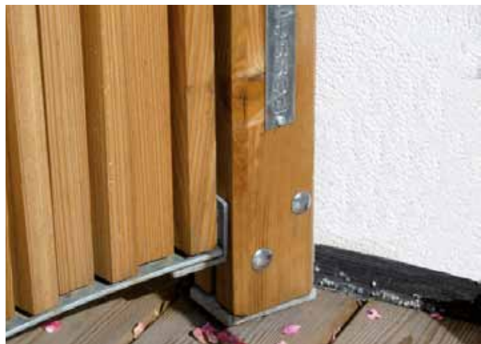
Sorgfältig verarbeitete Spezialanfertigung
